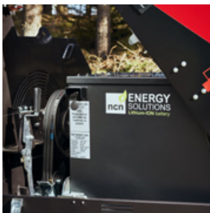
Kraftig 44 kWh batteri
